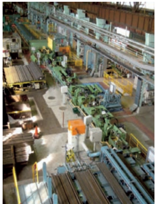
図1 75LCの設備全体像
