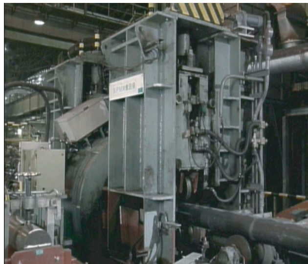
図3 鋼片RUSTの外観
