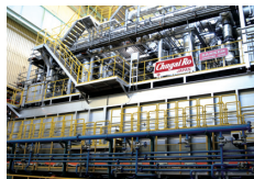
リジェネレーターを採用した省エネ加熱炉
