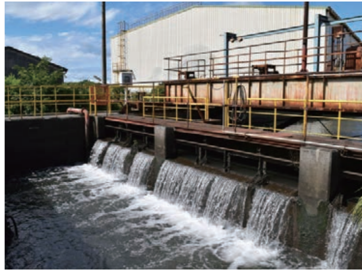
排水処理施設
