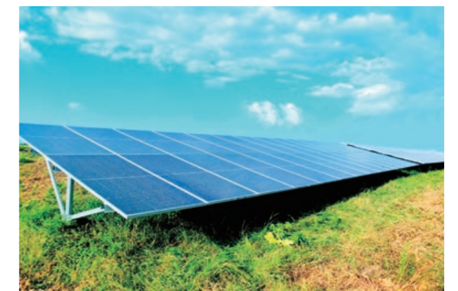
太陽光発電設備
