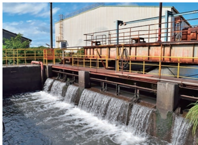
排水処理施設
