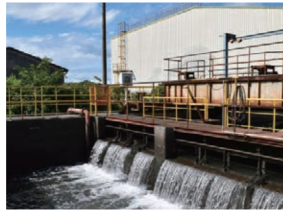
排水処理施設
