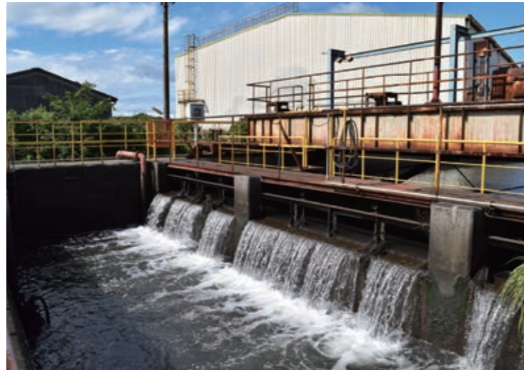
排水処理施設
