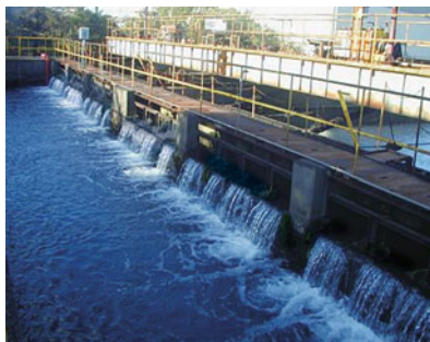
排水処理施設
