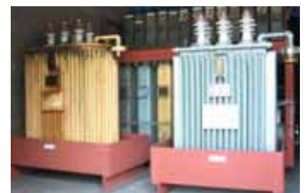
保管倉庫にて、PCB廃棄物を保管・管理しています。
