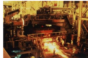
150トン電気炉 (1982年)
