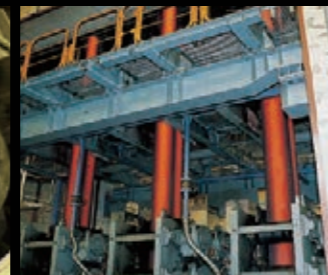
連続鋳造設備
